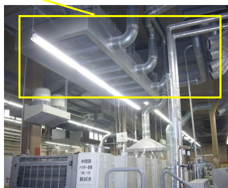
全体換気装置
