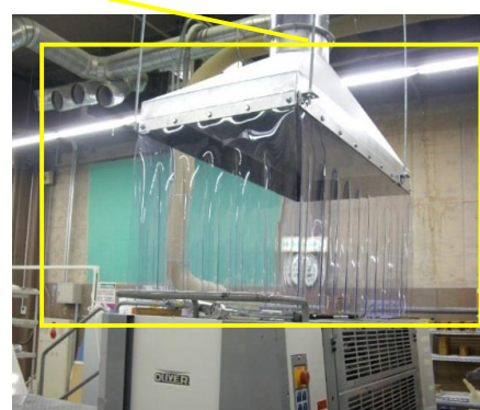
二スユニットのローラー一部の局所排気装置(囲込み)
